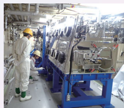
アクチニウム225抽出のために照射燃料集合体試験施設に設置されたグローブボックス
