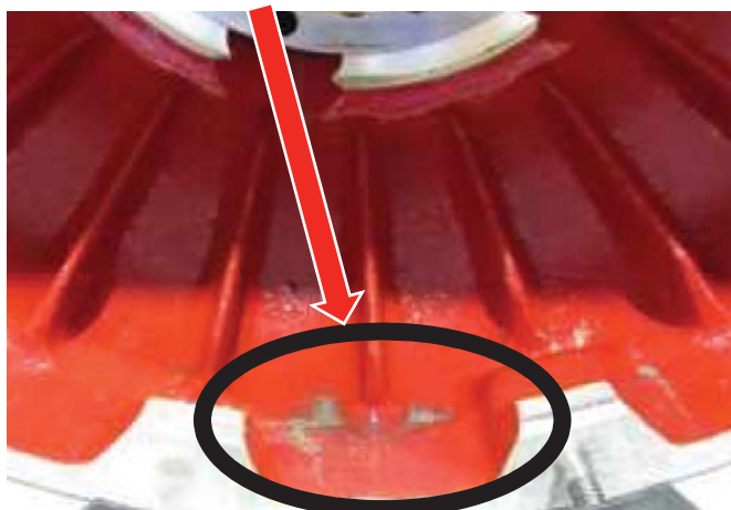
写真 9 軸受室内 (ブロワ側) の金属粉
