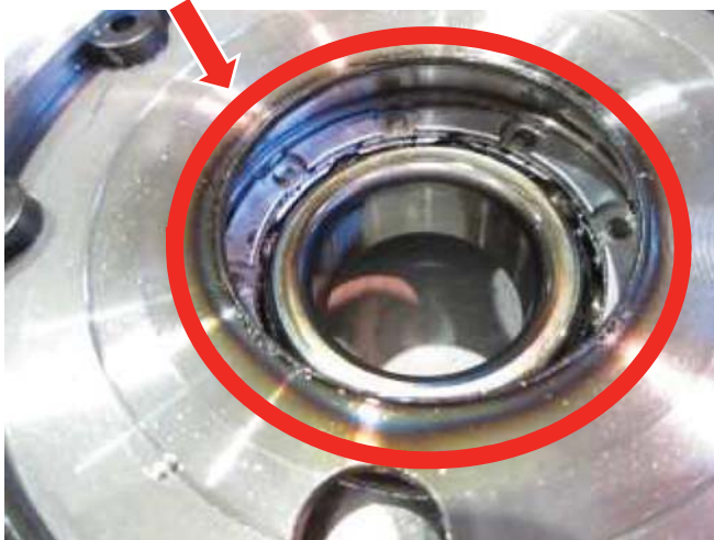
写真 3 タービン側ベアリング
