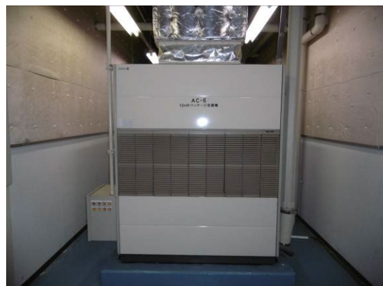
換気空調設備
