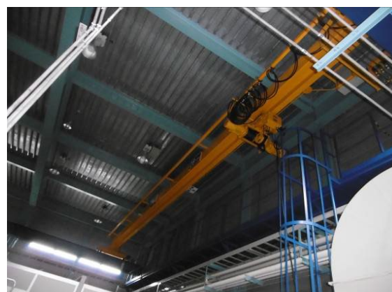
ホイスト式天井クレーン設備
