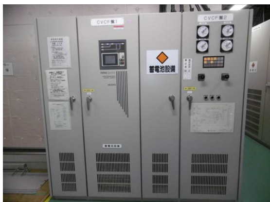
無停電電源装置設備
