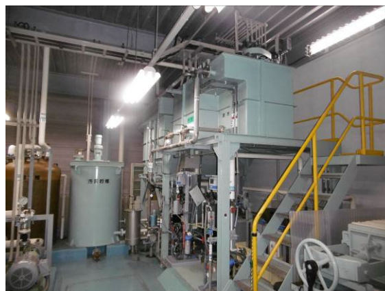
排水処理設備
