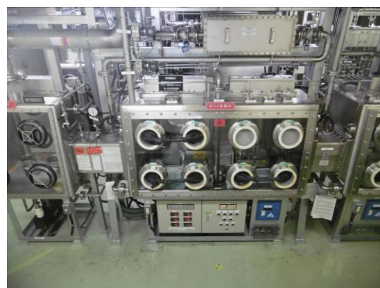
霧団気制御装置グローブボックス設備
