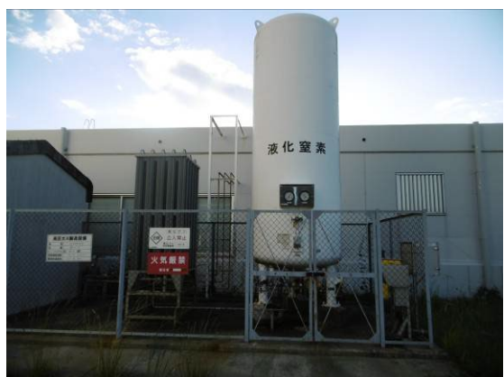
一般高圧ガス製造施設設備
