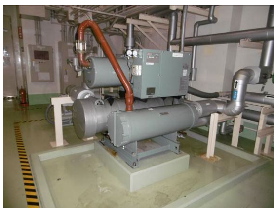
冷水・冷却水設備
