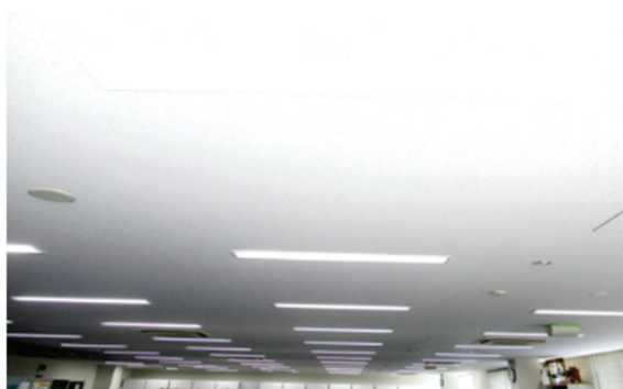
居室等への LED 照明の導入
