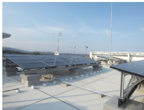
2015年10月から運用を開始した櫛葉遠隔技術開発センター屋上の太陽光発電設備
