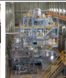
復旧したリチウム試験ループ
