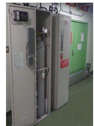
パッケージ型自動消火設備
