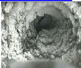
配管内に堆積物が発生
