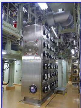
第2難燃物焼却設備の外観
