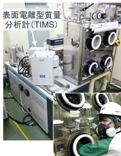
グローブボックス 放射性物質を取扱う分析設備
