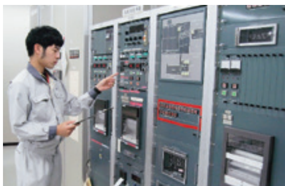
放射線監視盤（HPパネル）の点検風景
