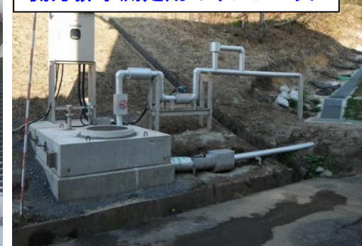
側方排水測定用のポンプピット
