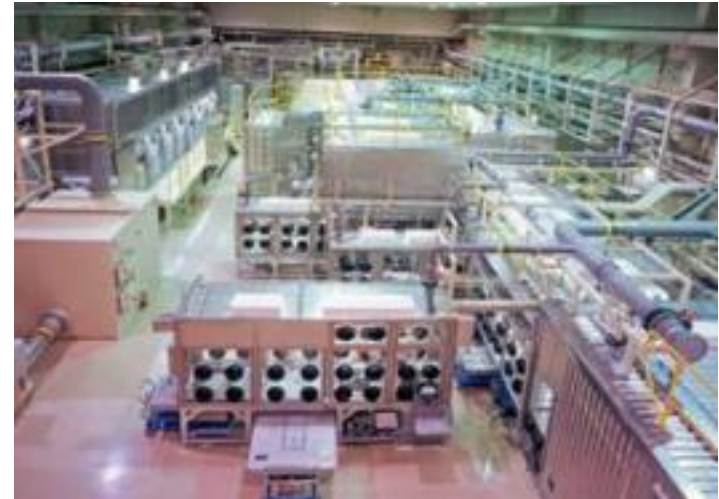
遠心機処理設備
