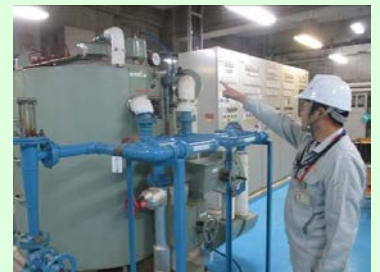
浄水施設の運転管理
