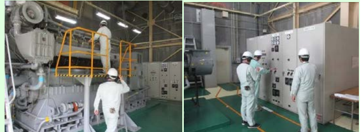
非常用発電機の試運転
