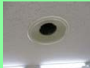
建物空調ダクト脱落 （補修済）、ほか
