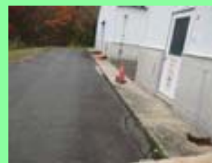
建物の基礎コンクリートとアスファルトの境界面の亀裂 （補修済）
