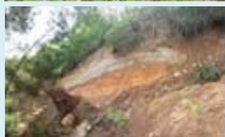
濃縮工学施設裏の法面 （平成29年10月台風21号豪雨）
