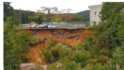
崩落箇所全景（北道路より南）
