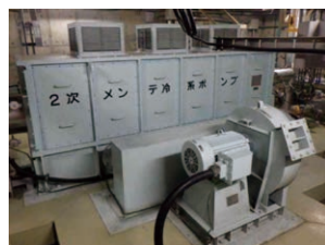
2次メンテナンス冷却系循環ポンプ
