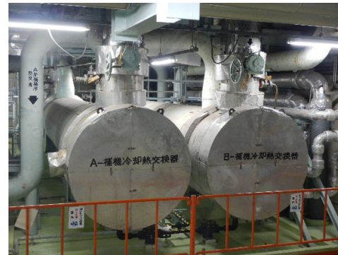
原子炉補機冷却熱交換器
