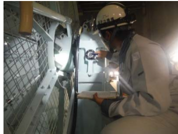
【ACS送風機 巡視点検】
