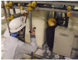
【機器冷却系冷却ポンプ分解点検作業】 (平成25年12月16日撮影)
