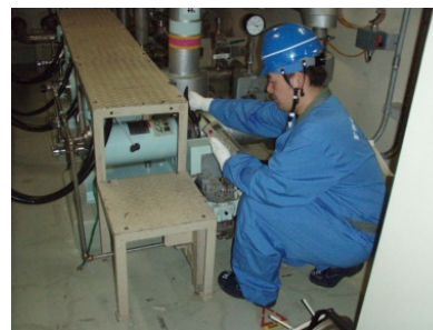
【共通保修設備ポンプ単体作動確認】 （撮影日：平成25年3月7日）
