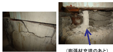
（内部から膨張し、ひびわれをおこしている）
