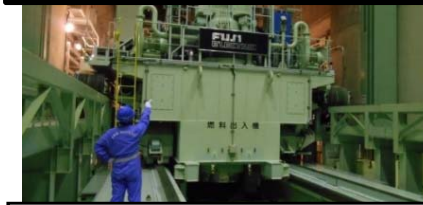
点検前作動確認：燃料出入設備
