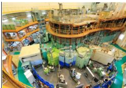
JRR-3原子炉建家 内実験装置
