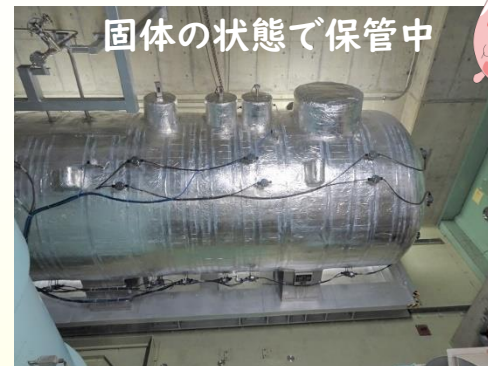
ナトリウム 一時保管用タンク
