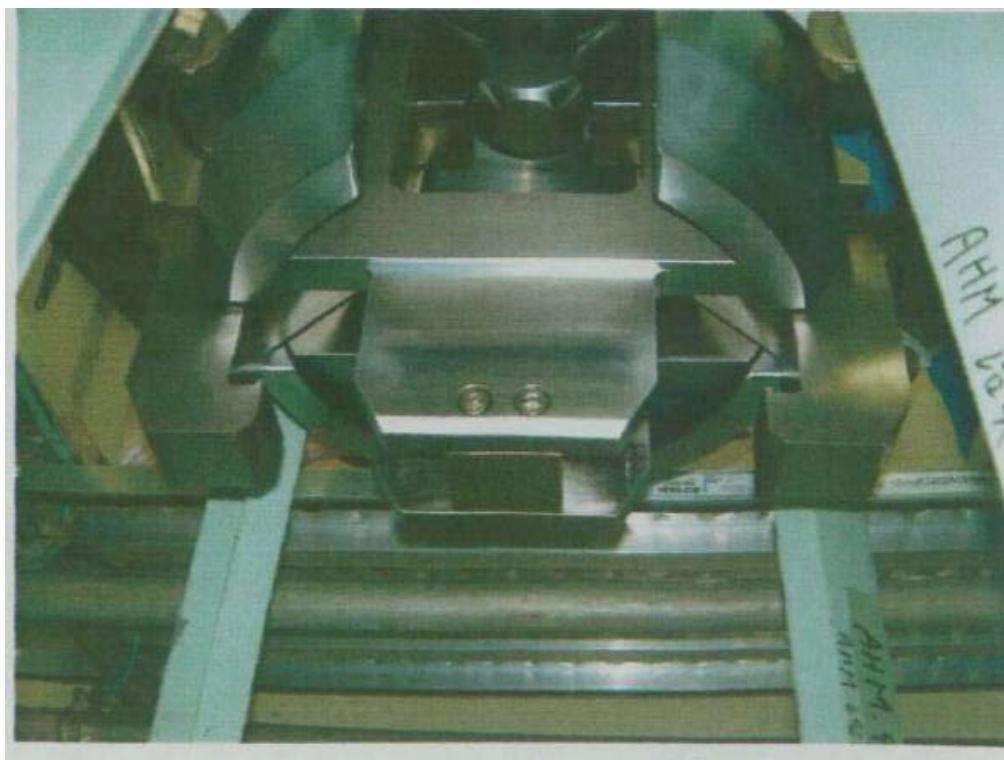
図 9.4.1-1 (1) パワーシリンダ交換前の爪開閉ロッドの取付け状態
