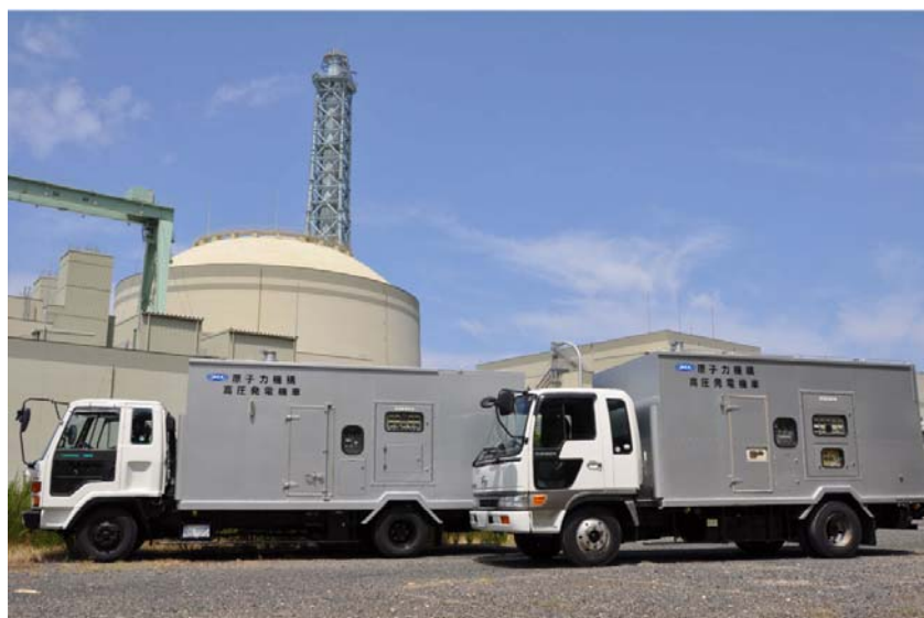
【新たに配備した電源車(300kVA×2台)】
