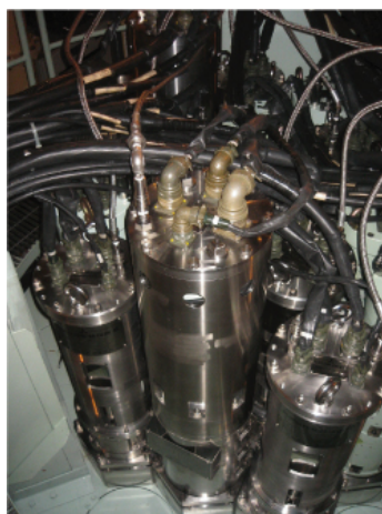
制御棒駆動機構(炉上部)
