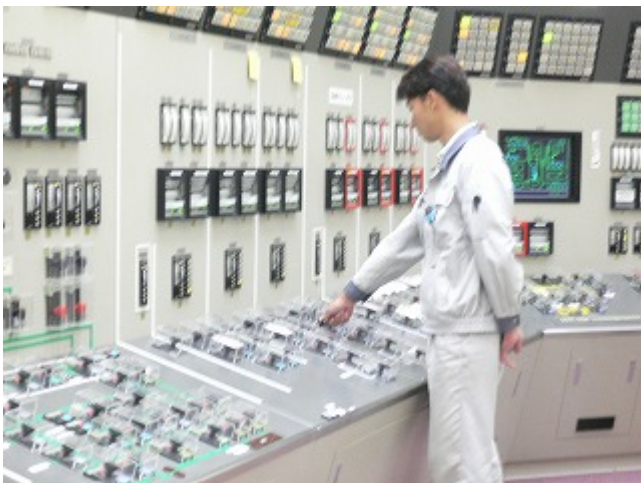
(2) 中央制御室内でのポンプ起動操作 (10:46開始)
