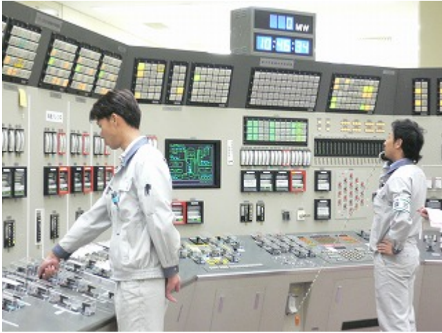
(1) 中央制御室内でのポンプ起動操作 (10:46開始)
