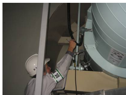
温度計の健全性確認 (C ループ)
