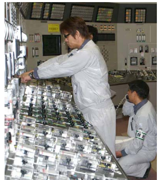
緊急ドレンスイッチ操作風景
