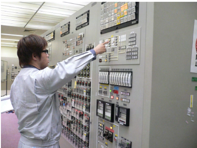
(3) 中央制御室内での窒素ガス注入開始操作後確認
