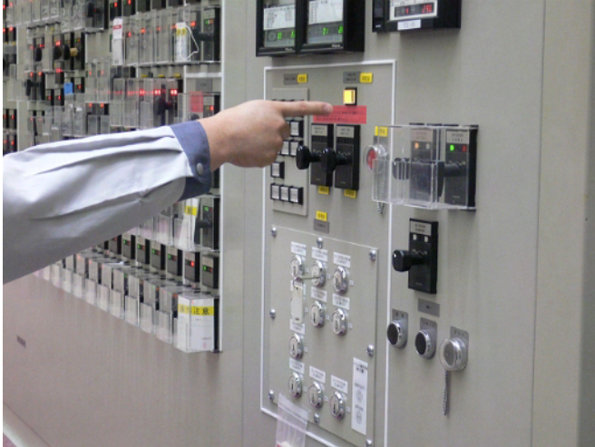
(1) 中央制御室内での窒素ガス注入開始操作前確認
