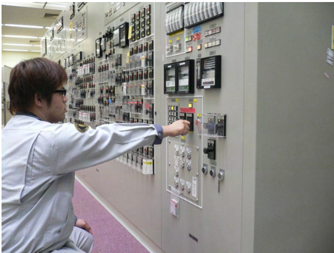
(2) 中央制御室内での窒素ガス注入開始操作 (17:55開始)
