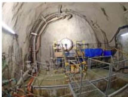
止水壁（深度500m研究アクセス北坑道）
