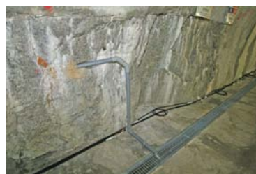
地層露出部分と 地下水が湧き出ている部分
