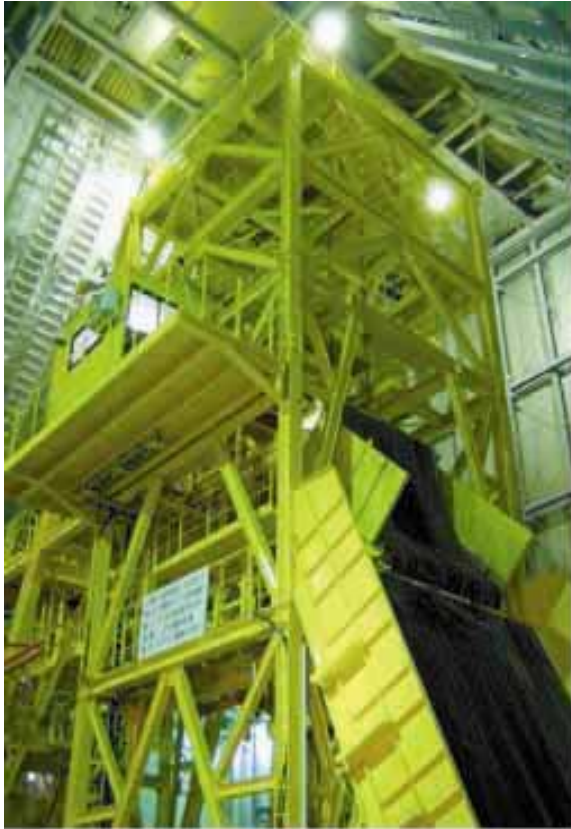
換気立坑櫓（やぐら）設備
