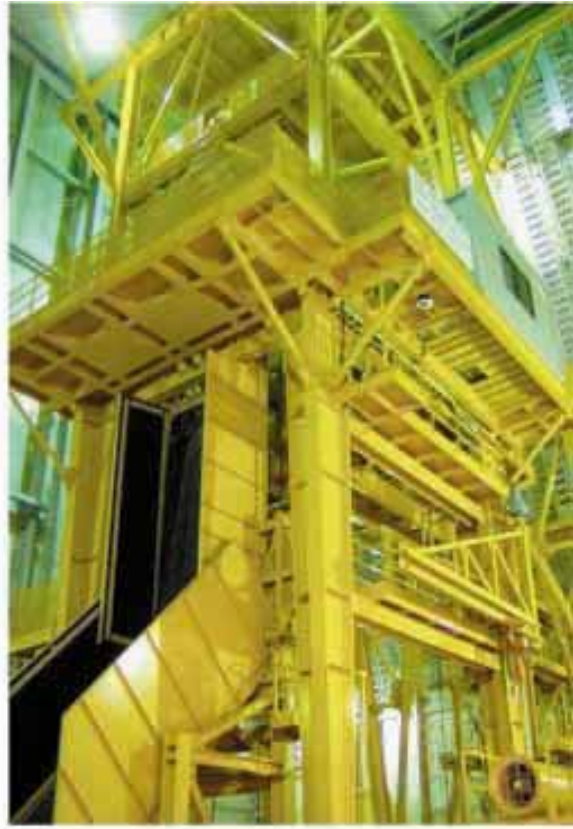
主立坑櫓（やぐら）設備
