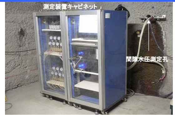
間隙水圧測定装置設置状況
