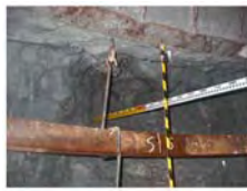
坑壁崩落の発生状況 (主立坑)
