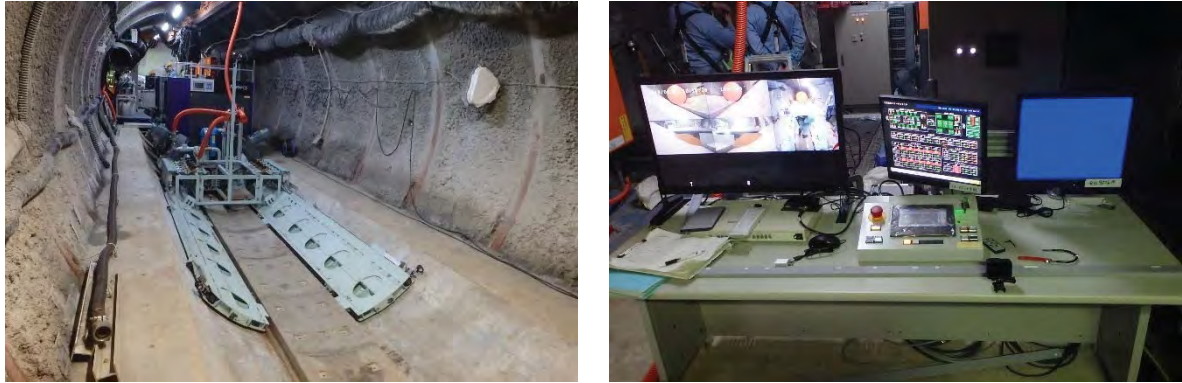
図 4.2.2.1-28 試験坑道 2 に設置した定置・回収試験装置と遠隔操作卓
