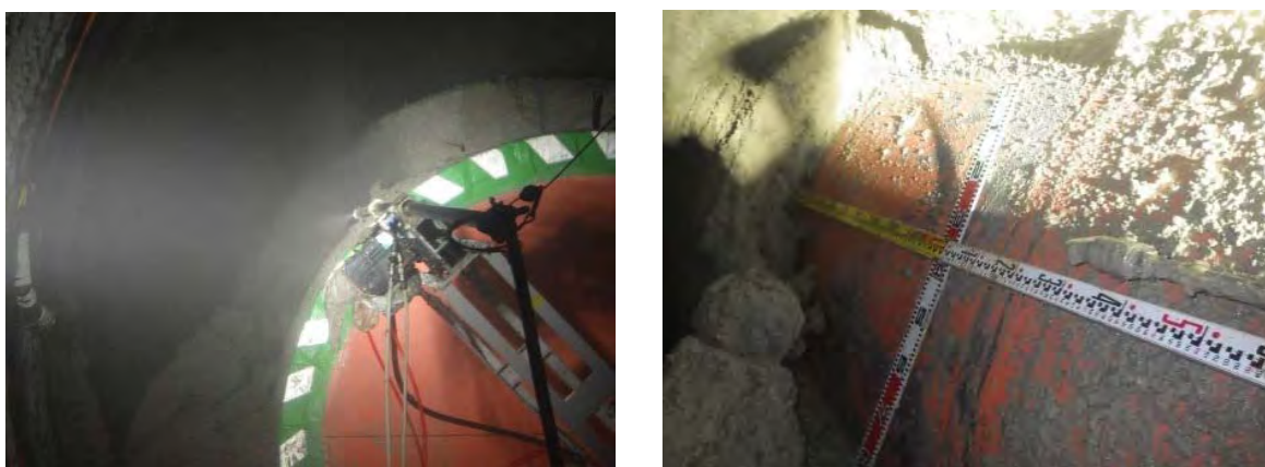
図 4.2.2.1-25 上部開放部の模擬 PEM 近傍の充填材に対するトルネードノズルの効果
