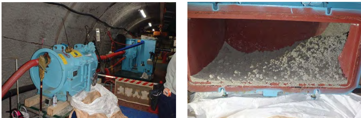
図 4.2.2.1-21 切削物捕集装置と捕集タンク内の様子
