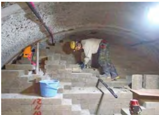
(a) 設置状況
