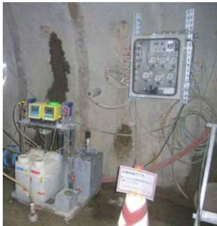
図 2.3.2-15 還元環境回復能力に関わる調査試験装置（深度 250m 調査坑道）
