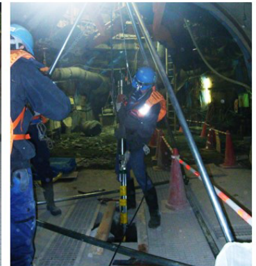
マルチ光計測プローブ設置状況
