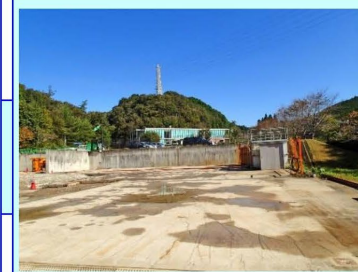
②排水処理設備 :完了 2021.7.2
