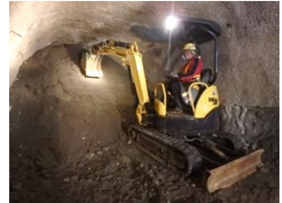
水平坑道の埋め戻し作業 深度500m研究アクセス南坑道 写真の坑道規模：幅4m、高さ3.5m
