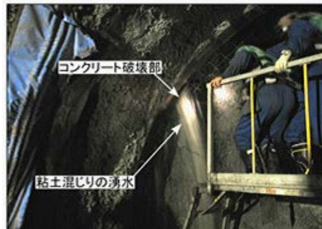
大量湧水発生状況
