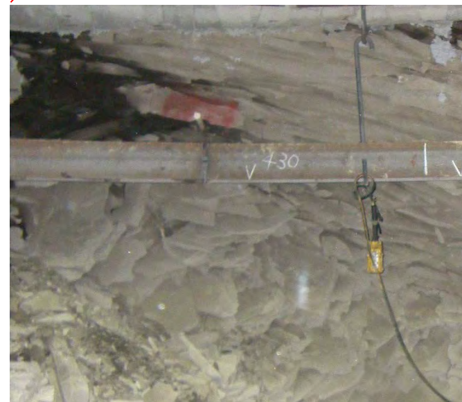
東立坑深度370m付近の側壁面に発達した割れ目
