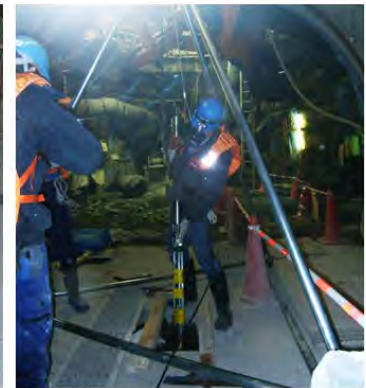
マルチ光計測プローブ設置状況
