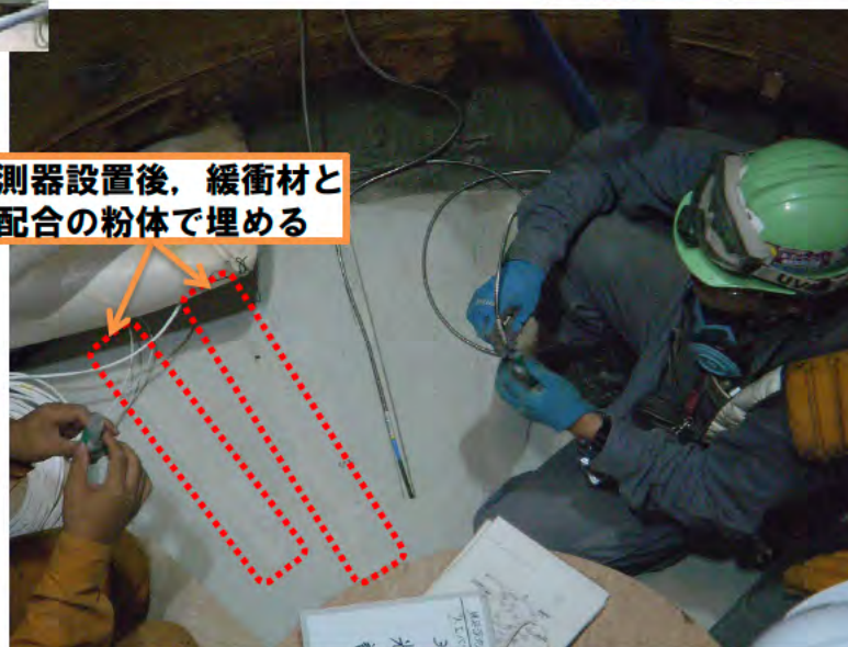
計測器設置状況
