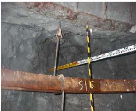
花崗岩礫の抜け落ち箇所 (深度147m付近、奥行き最大約1.2m)
