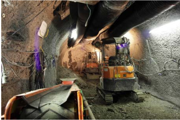
切羽掘削：ブレードによる掘削とバケットによる掘削土(ズリ)の積込み
