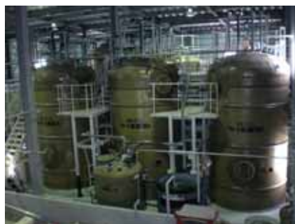
キレート吸着塔 (ホウ素の吸着除去)
