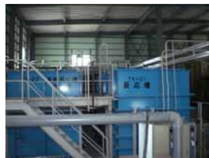
反応槽 (窒素(アンモニア)の除去)
