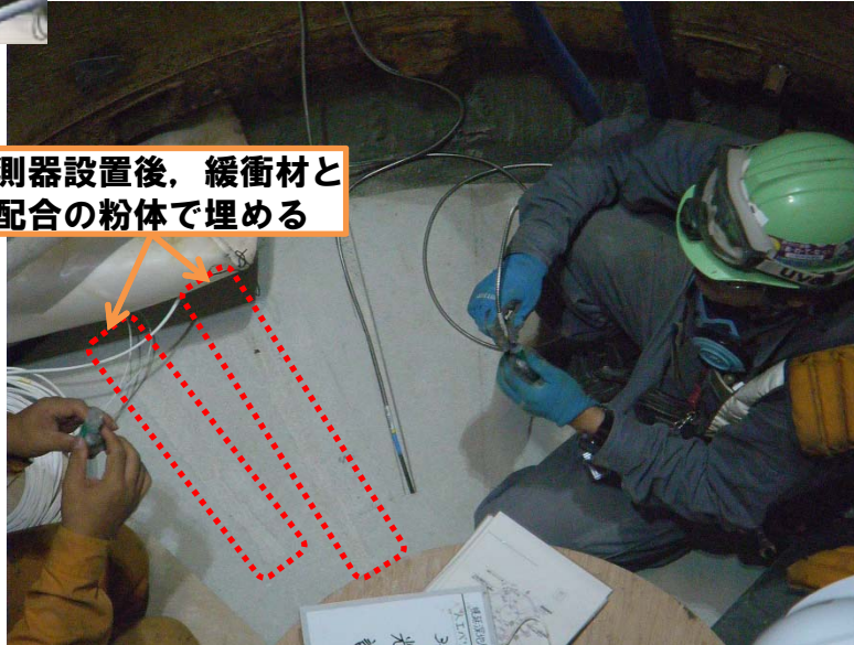
計測器設置状況
