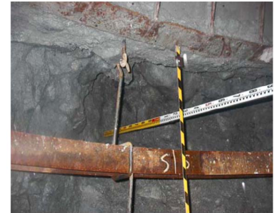
抜け落ち箇所 (深度147m, 奥行き1.2m)
