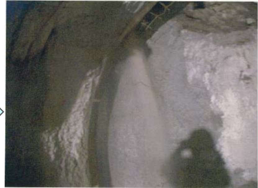
周回坑道(東)湧水発生箇所の写真
