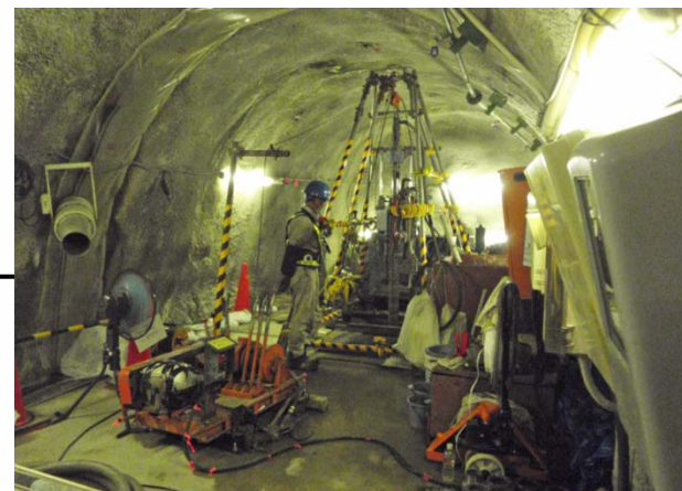
東濃地震科学研究所 応力計設置（施設供用）
