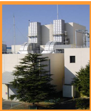
主冷却機建物外観
