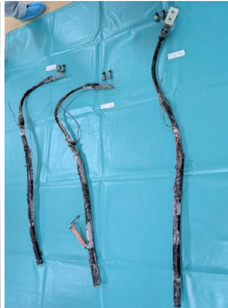
高圧配電盤内から取り外した ケーブル
