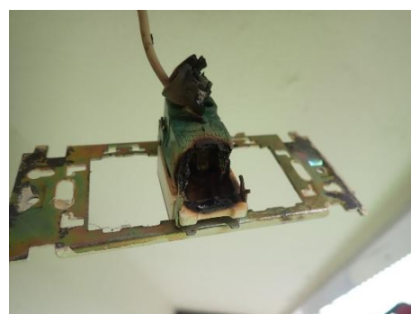
照明スイッチ焦げ跡
